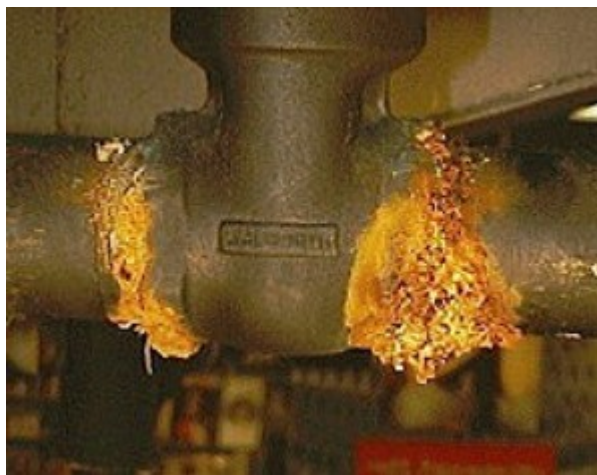
شکل ۵۲: نمونه ای از خوردگی گالوانیک در اتصال خط لوله [۴]
